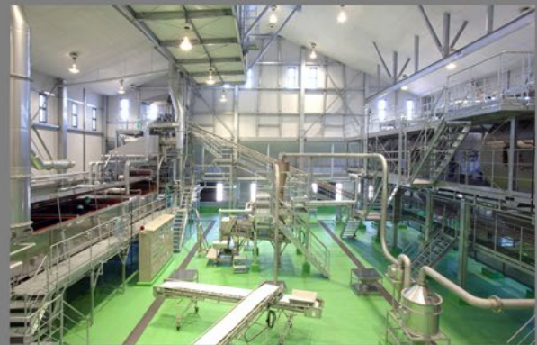
プラント設備
